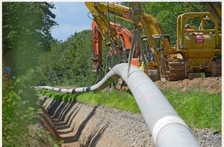
Bild 1: Auf 71 km Länge von Au am Rhein nach Leonberg wurden 4.000 Rohre verlegt – das sind rund 11.000 Tonnen Stahl Quelle: terranets bw
